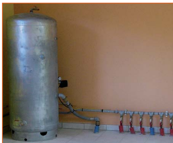
Vannes individuelles regroupées dans le local technique
