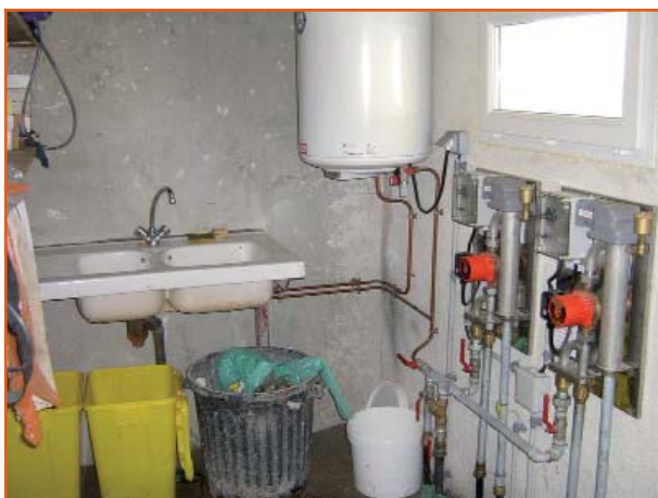
Un minimum de place doit être réservé dans le local technique pour l'installation du circulateur
